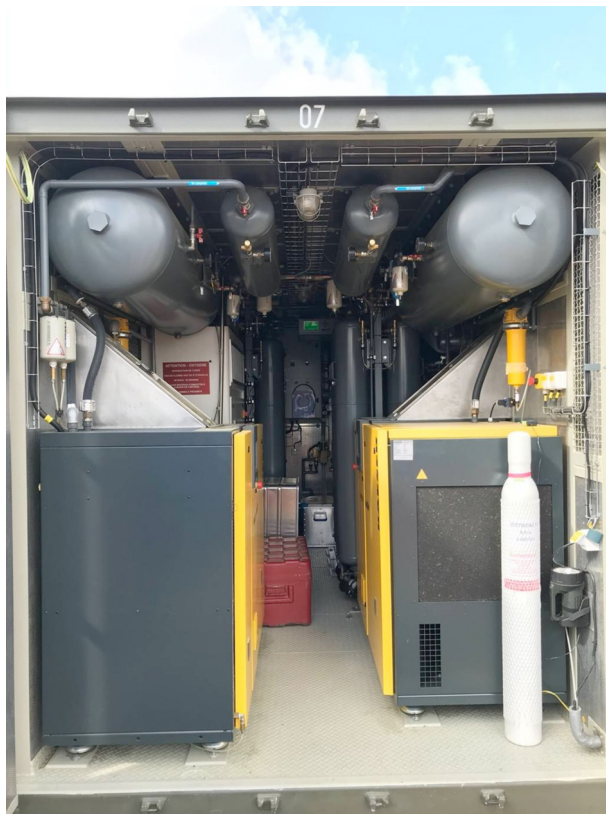
FIGURE 3 Module de production d'oxygène grande capacité, MPOGC®
