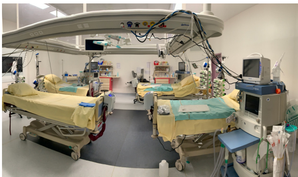
FIGURE 4 Photographie d'un bloc opératoire équipé de 4 lits de réanimation
